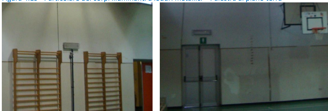
Figura 4.19 - Particolare dei corpi illuminanti a ioduri metallici – Palestra al piano terra
