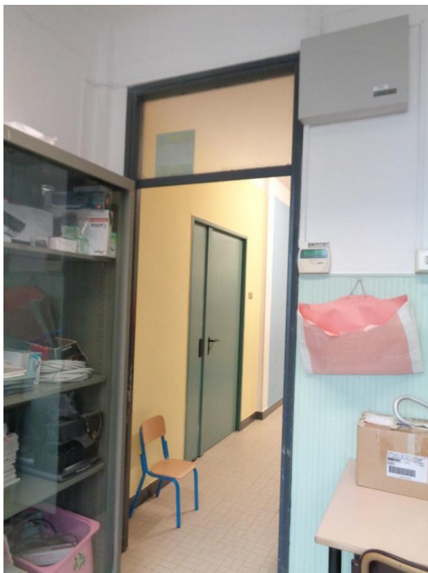
Figura 4.8 - Particolare di termostato di regolazione
