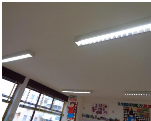
Figura 4.18 - Particolare dei corpi illuminanti ubicati nelle Aule
