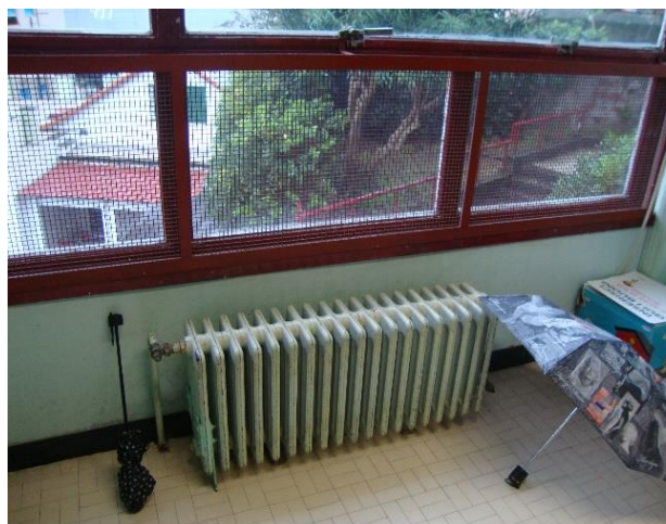
Figura 4.6 – Particolare radiatore in acciaio
