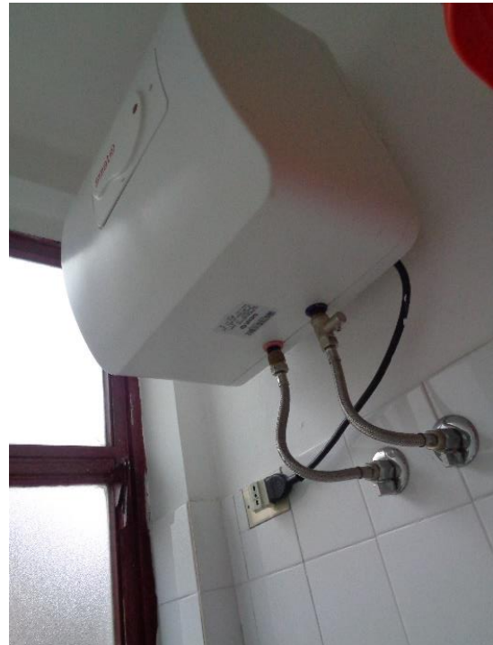
Figura 4.16 - Particolare di un boiler elettrico per la produzione di acqua calda sanitaria
